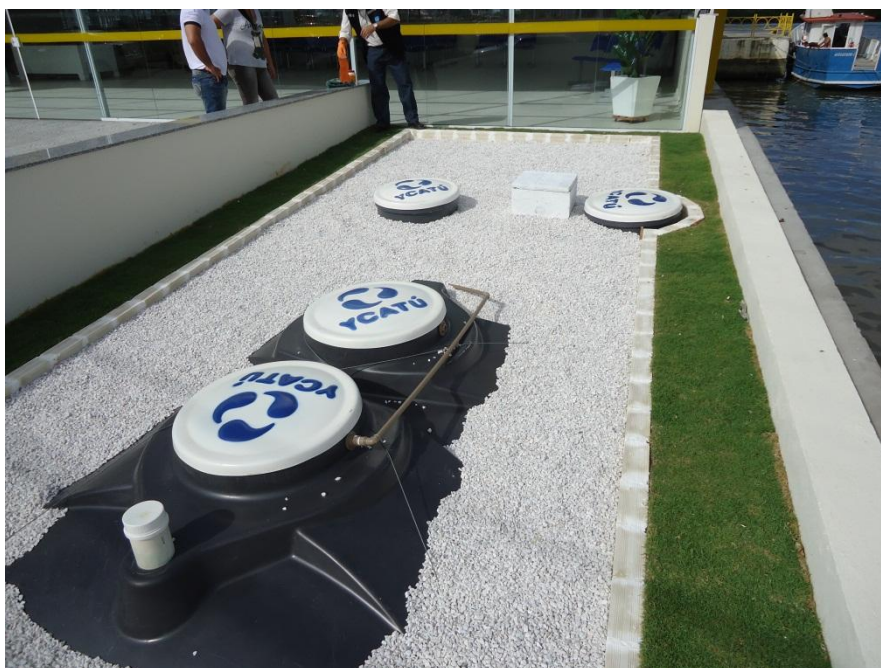
Figura 13. ETE instalada no píer.
