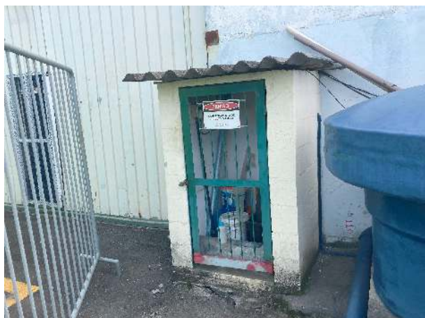
Figura 32: vista do ponto de adição de hipoclorito de sódio nos efluentes da ETE.
