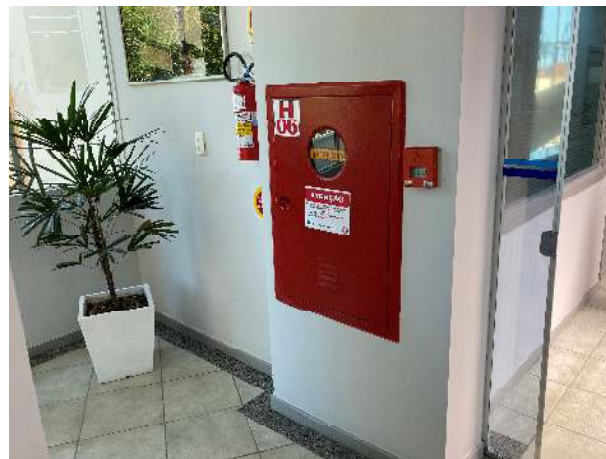
Figura 6: vista de um dos pontos da rede de Hidrantes da auditada.
