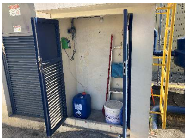
Figura 27: vista do ponto de adição de hipoclorito de sódio nos efluentes da ETE.
