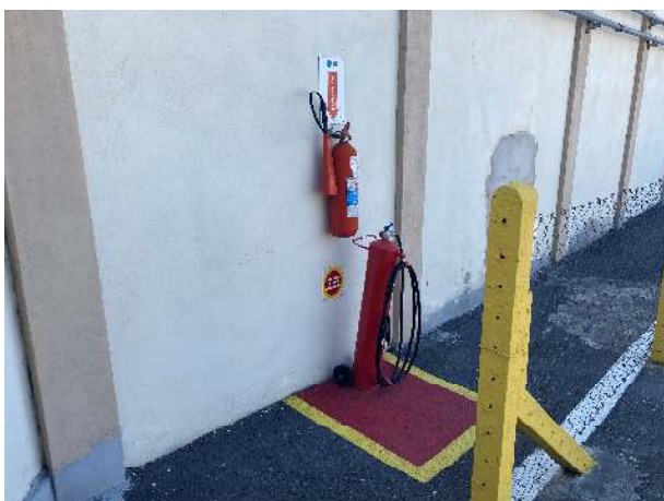
Figura 7: vista de extintores disponíveis na auditada.
